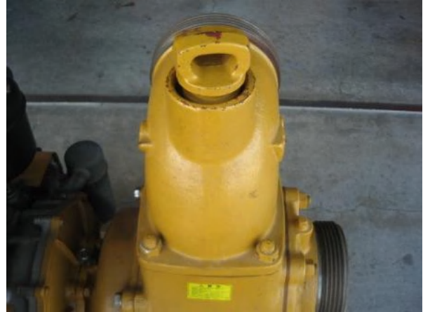
放口上部の栓を外す
