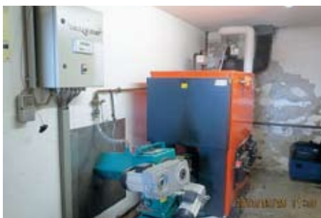
チップボイラー
