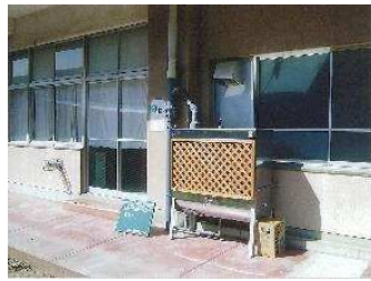
雨水貯留タンク設置例
