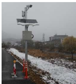
簡易型 河川監視カメラ
