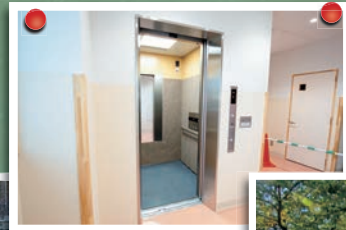
▲エレベーター
