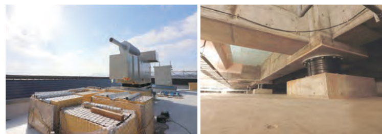
▲72時間の災害対応が可能な非常用発電機
