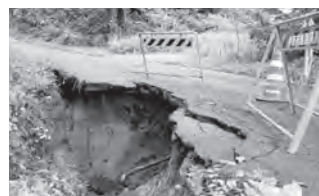
▲長沢線道路崩落 (H28)
