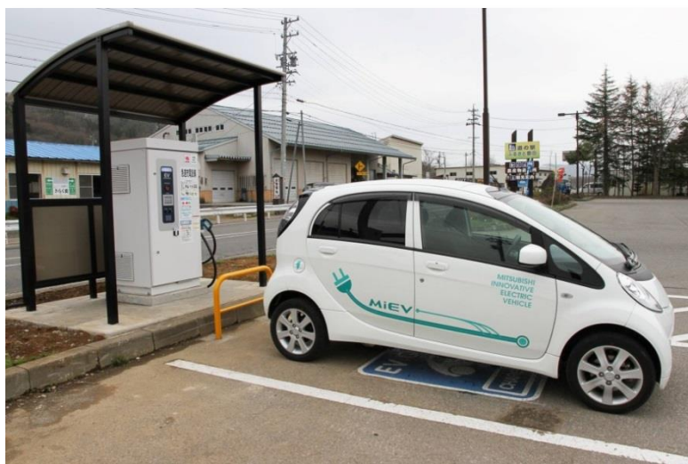
電気自動車用充電設備(道の駅ふるさと豊田)
