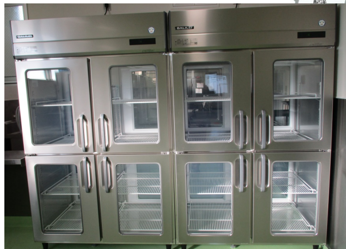
魚肉下処理室用冷蔵庫
