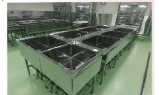
⑮下処理用3槽シンク
