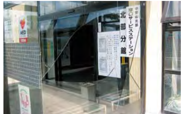
▲北部公民館(正面玄関ガラス破損)
