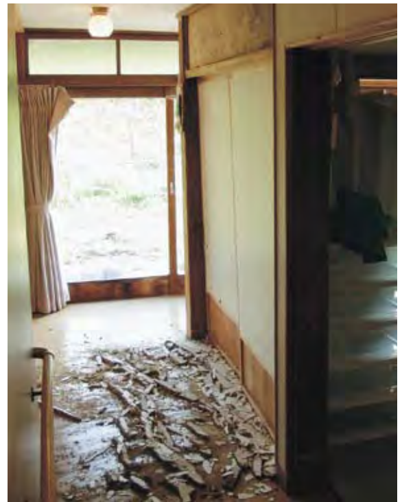
▲民間グループホーム(内壁一部崩落)
