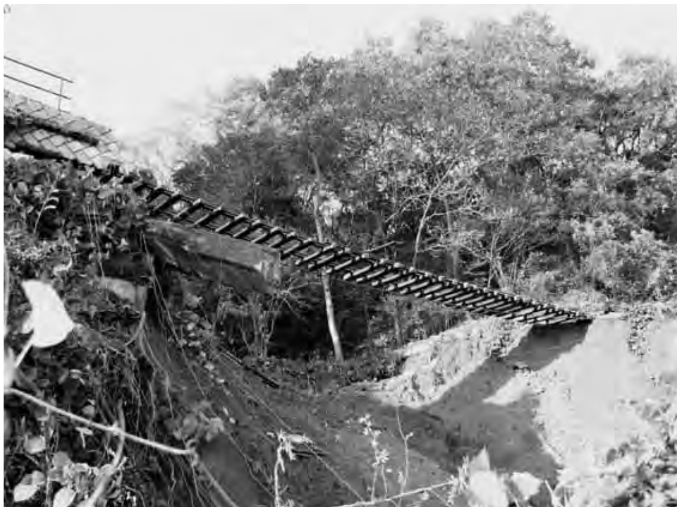
▶豊田地域に発生した土砂災害により、宙に浮いたJR飯山線昨年10月の台風23号
