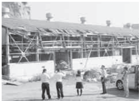
▲津波で被害を受けた建物
