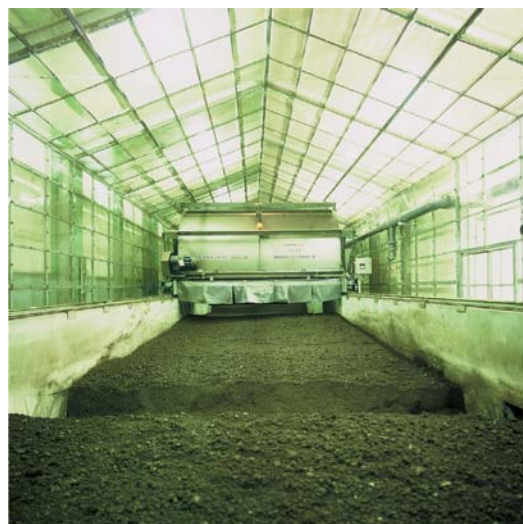
農業集落排水事業汚泥堆肥化施設の2次発酵槽
