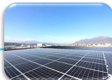
市役所本庁舎の太陽光発電設備
