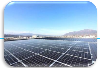
市役所本庁舎の太陽光発電設備
