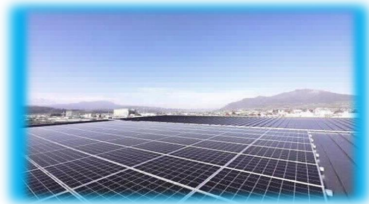
市役所本庁舎の太陽光発電設備
