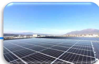
市役所の太陽光発電設備
